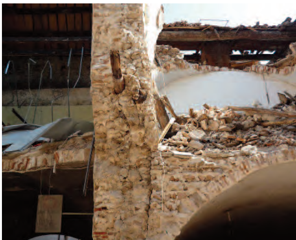
5. L'Aquila. Il collasso della facciata consente di riconoscere la presenza del radiciamento ligneo al centro della parete.
