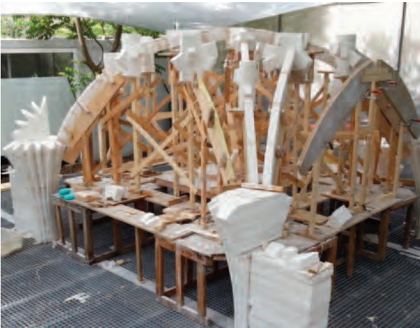
10. Montaje de la cimbra, la plataforma de trabajo y los pies derechos ya coronados con sus correspondientes claves.
