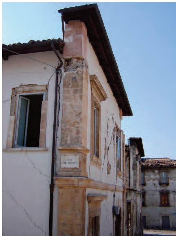
1. L'Aquila. Le lesioni diagonali (meccanismo di secondo modo) su entrambe le pareti esterne di un edificio prospettante sulla piazza San Pietro di Coppito dimostrano il comportamento scatolare dell'assemblaggio murario.
