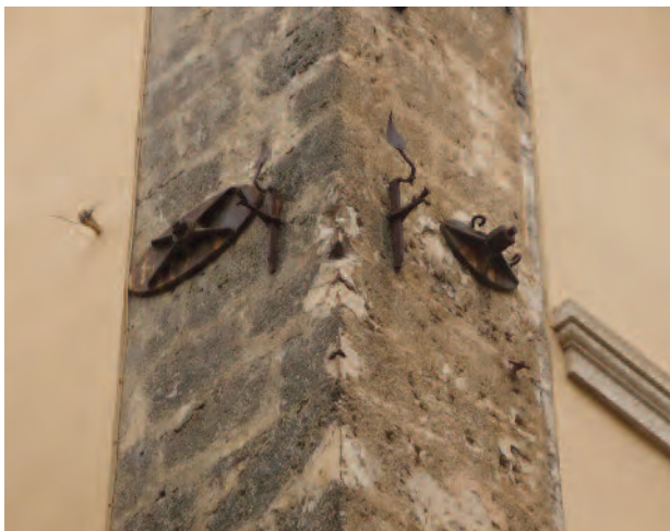
3. L'Aquila. I differenti capochiave sull'angolata muraria evidenziano la presenza di catene recenti (XX secolo) che si affiancano ai più antichi radiciamenti lignei.
