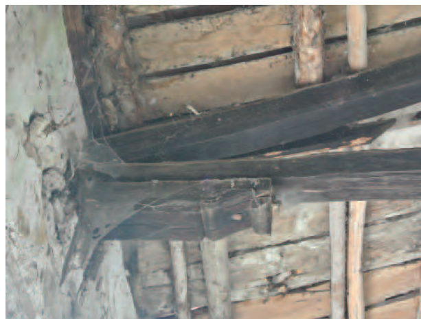
11. Fossa (AQ). Vista dall'interno della mensola d'appoggio di una capriata di copertura ancorata esternamente con un paletto ligneo (impalettatura).
