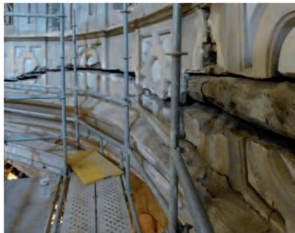
10. Calatayud (Zaragoza). Colegiata de Santa María, detalle del arranque del tambor de la cúpula, durante las obras de consolidación de 2014. La grieta horizontal delata la existencia del encadenado lúneo original, que se evidencia en la cata que se observa en primer término.
