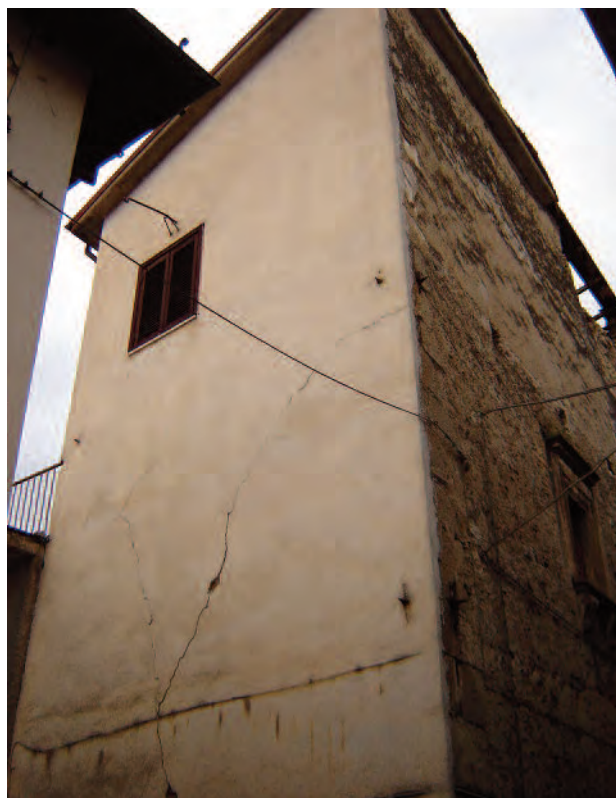
2. Paganica. Ribaltamento fuori piano (meccanismo di primo modo) della porzione sommitale di una sopraelevazione recente confrontata con il comportamento scatolare della parte sottostante garantito da presidi antisismici efficaci.
