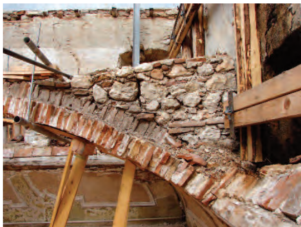
9. L’Aquila. Volta a padiglione in palazzo Ardinghelli, ricostruita dopo il 1703, con elementi lignei disposti all’imposta delle quattro falde reciprocamente collegati a mezzo legno e ancorati alle pareti esterne.
